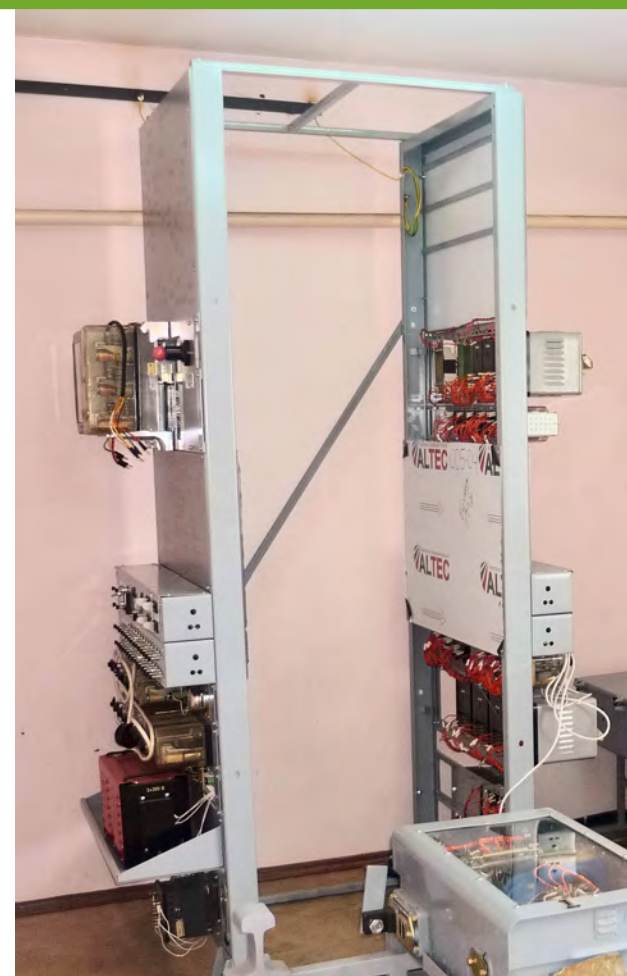
Установленные тренажёрные комплексы выполнены с использованием реальной аппаратуры СЦБ, они одни из самых применяемых на магистрали.
